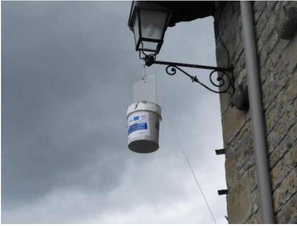
Figura 7. Luminaria de alta peligrosidad para las especies voladoras ya que tiene una lámpara de VM y la base abierta. Los insectos, atraídos por la luz, acceden al interior y se queman al entrar en contacto con la lámpara. Iziz (Valle de Salazar).
